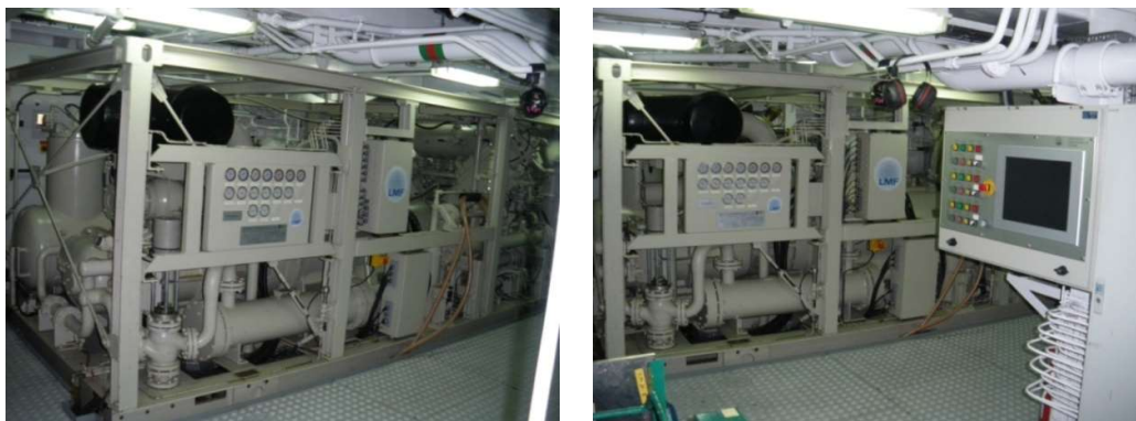
Fotos 3 y 4 . Compresor LMF 25/138-207-E50 instalado a bordo del Sarmiento de Gamboa.
