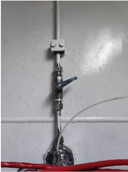
Fuga en la línea exterior de nitrógeno
