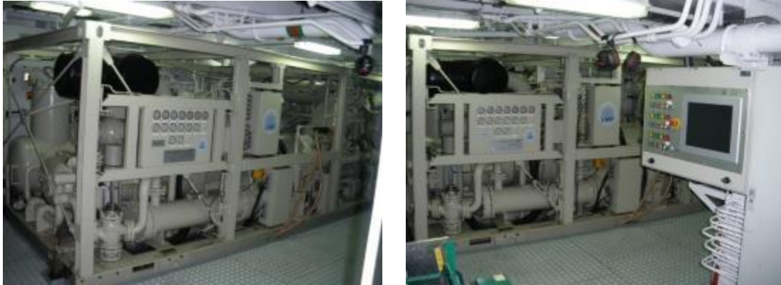
Fotos 5 y 6. Compresor LMF 25/138-207-E50 instalado a bordo del Sarmiento de Gamboa.
