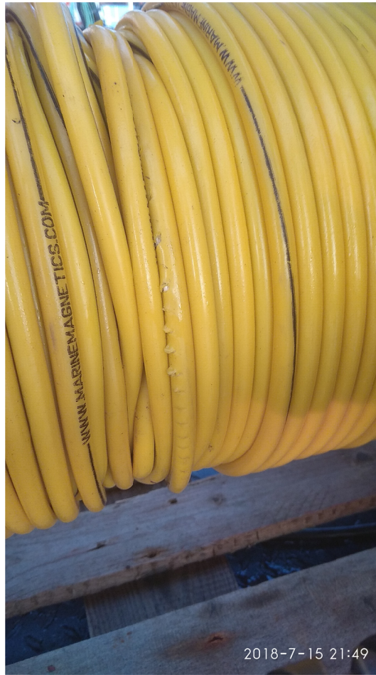
Figura 45. Cable de tiro dañado por el desplazamiento del devanador de la maquinilla
