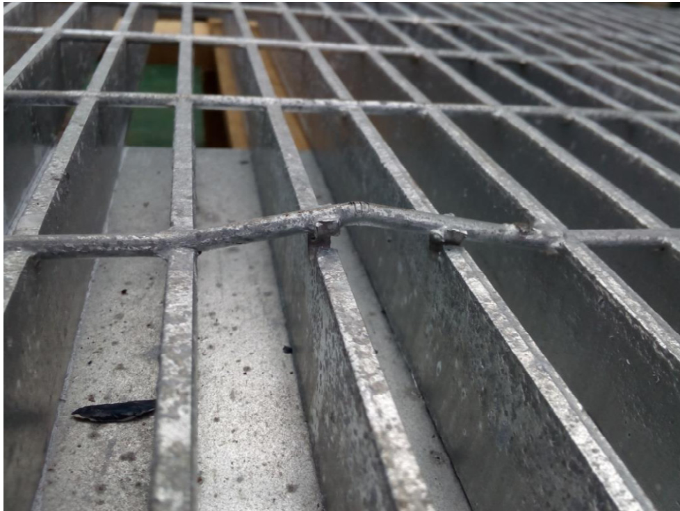
Foto 1. Varilla deformada por la tracción ejercida durante la maniobra de anclaje.
